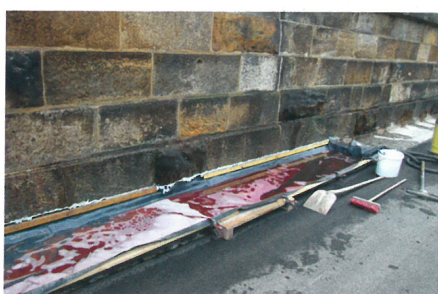
(5) Die Schmutzflotte aus Wasser und eingesetztem Reinigungsmittel wird in dem dafür gebauten Becken aufgefangen, anschließend abgepumpt und fachgerecht entsorgt.
